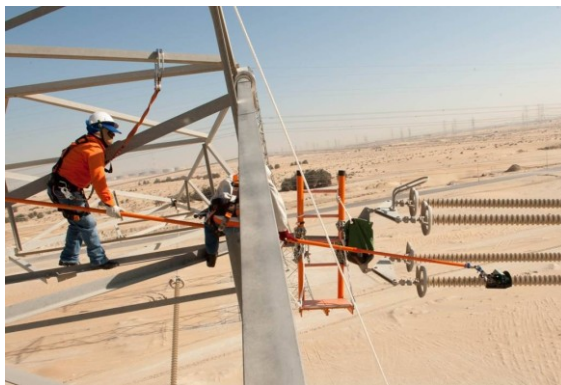
Проверка композитного изолятора с использованием метода измерения электрического поля
